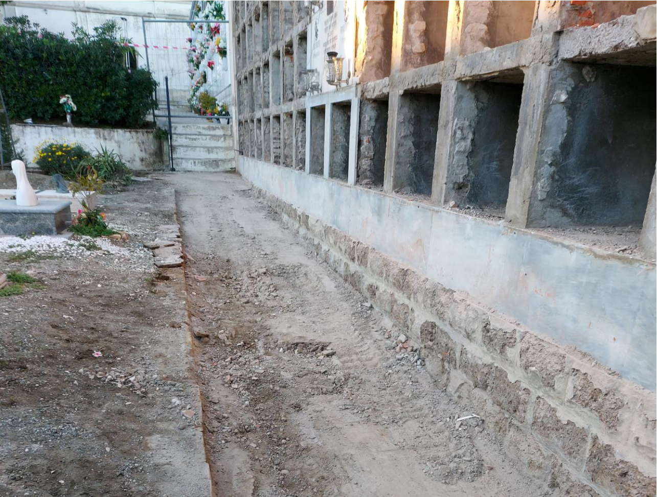
PARTICOLARE MARCIAPIEDE DA RIPRISTINARE
